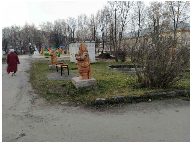
Частичное отсутствие бордюрного камня, на участках где он присутствует - бордюр с многочисленными сколами;
