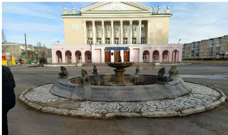
Фонтан, расположенный на площади у главного входа в Дворец культуры, находится в полуразрушенном состоянии.
